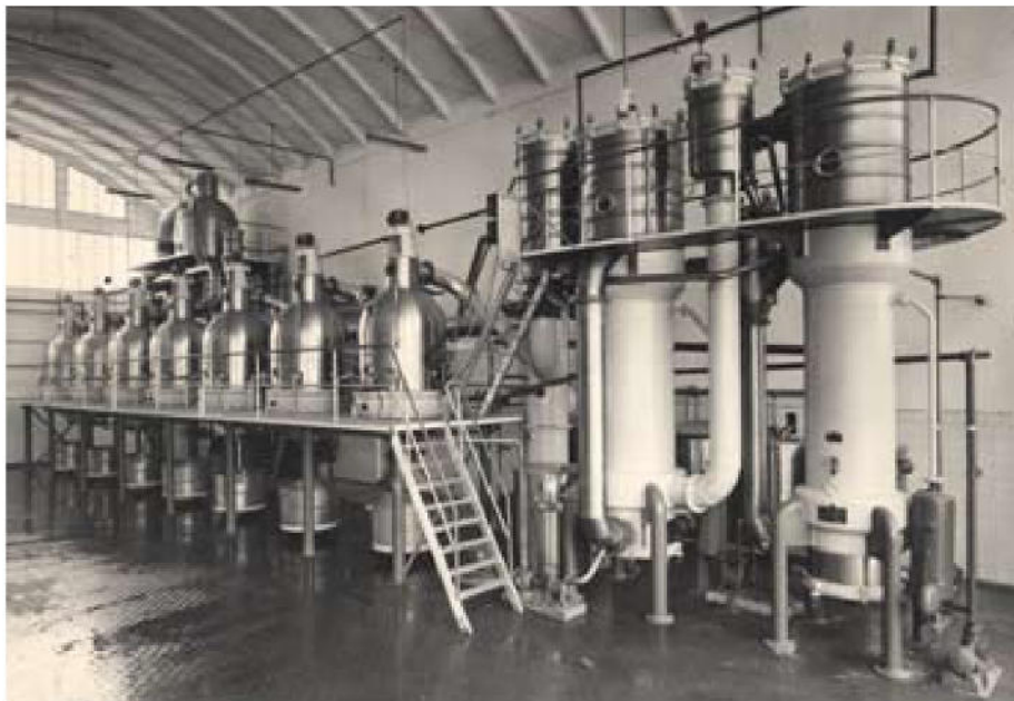
Impianto di evaporazione con concentratore continuo e finitura in bulle, 1957
